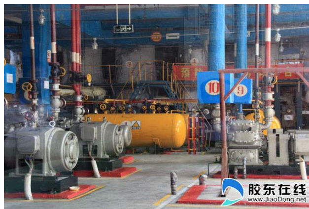
图 21：氨制冷用压力容器压力管道
