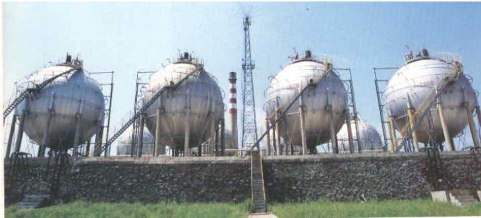
图 6：固定式压力容器（球形储罐）
