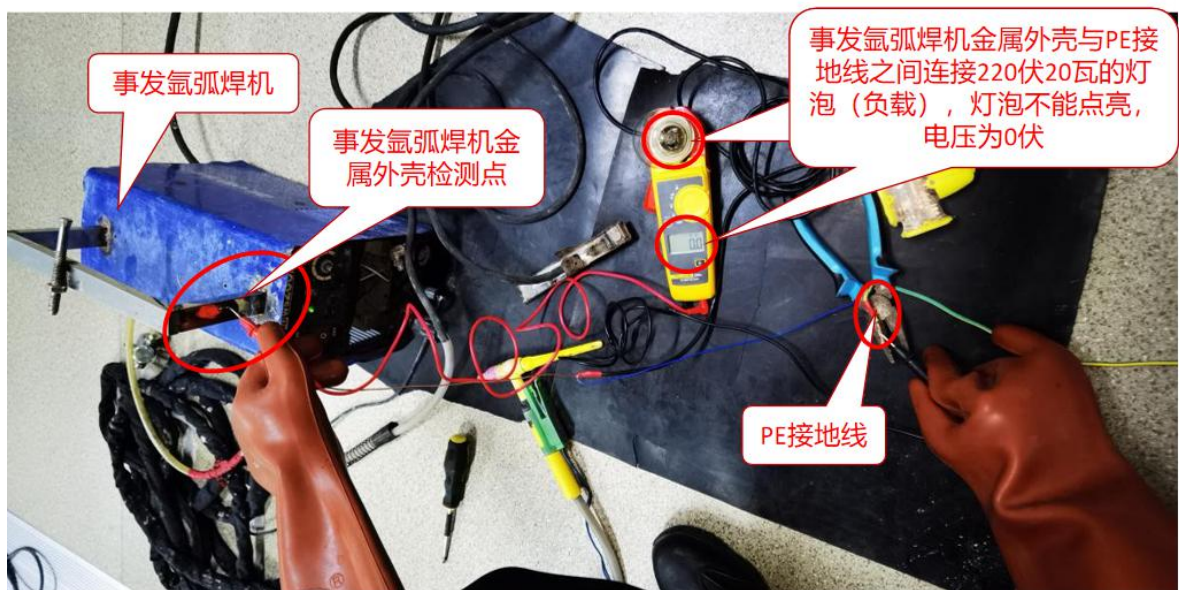
图 23 事发氩弧焊机金属外壳与 PE 接地线之间连接 220 伏 20 瓦的灯泡（负载）测试情况图
