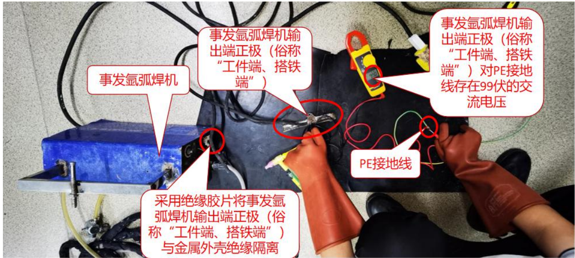
图 20 采用绝缘胶片将事发氩弧焊机输出端正极与金属外壳绝缘隔离后， 事发氩弧焊机输出端正极带电检测情况图
