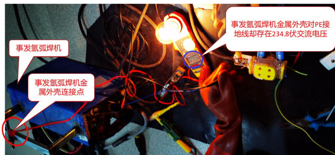
图 27 采用绝缘胶片将事发氩弧焊机输出端正极与金属外壳绝缘隔离后，事发氩弧焊机金属外壳带电检测情况图
