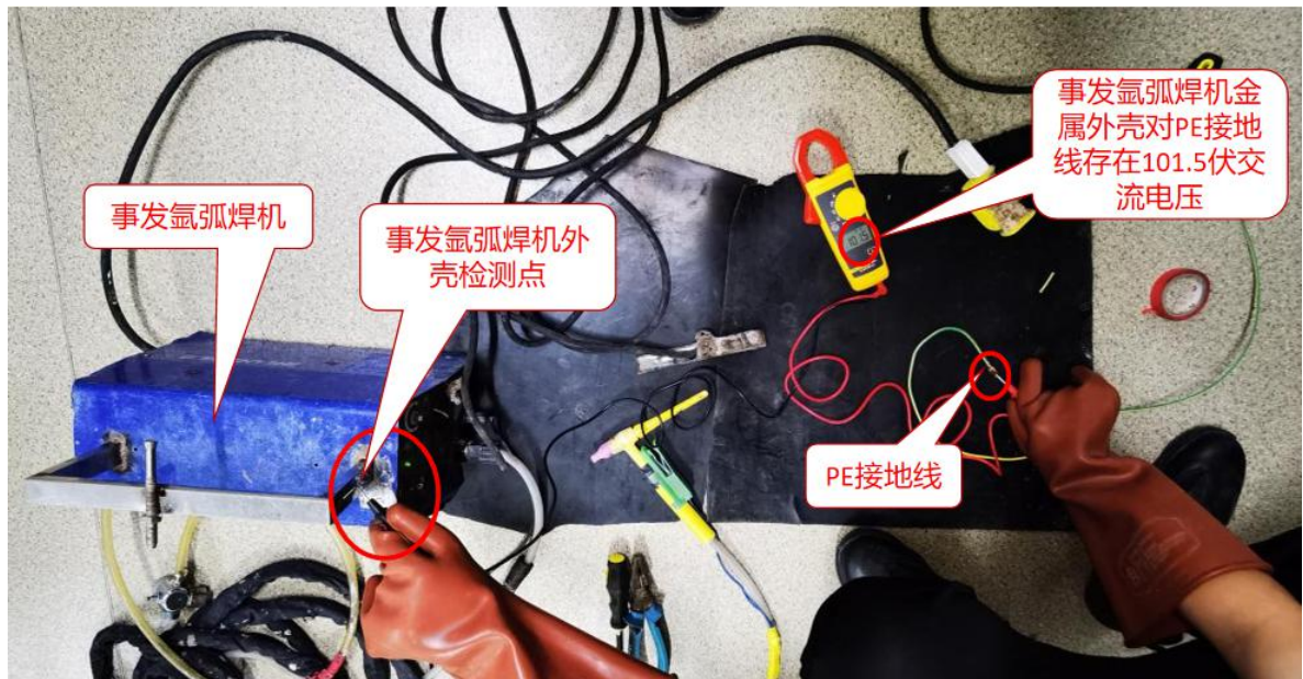
图 21 采用绝缘胶片将事发氩弧焊机输出端正极与金属外壳绝缘隔离后， 事发氩弧焊机金属外壳带电检测情况图
