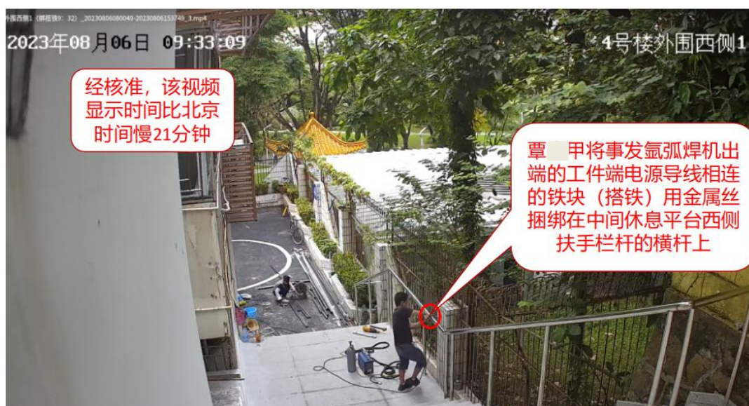
图 10 覃某甲将事发氩弧焊机出端的工件端电源导线相连的铁块（搭铁）用金属丝捆绑在室外步梯中间休息平台西侧扶手栏杆的横杆上视频截图
